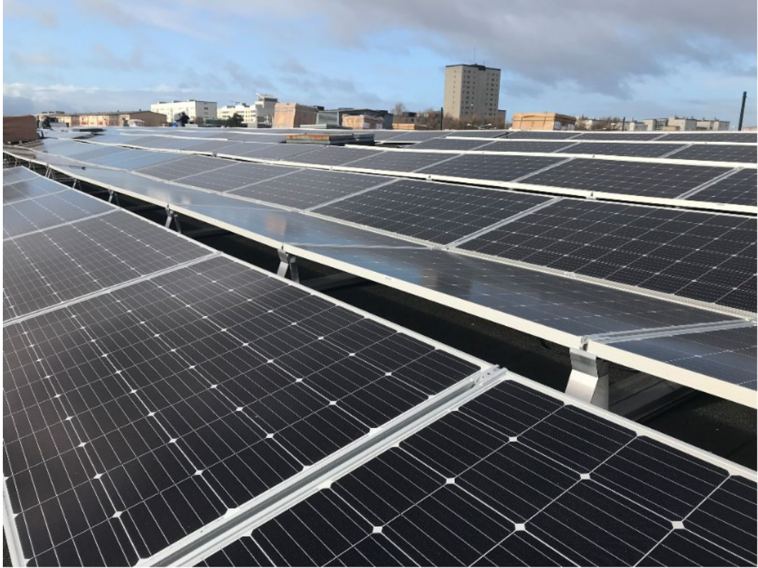
Bild: Solceller på taket i Mobilia. Foto: Atrium Ljungberg
